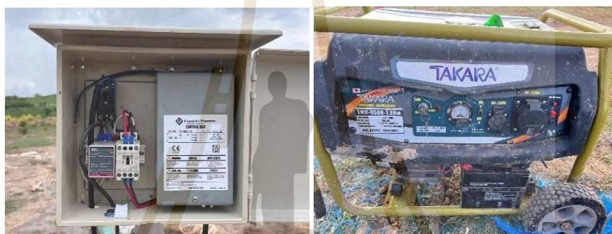
รูปที่ 3.4 ชุดตู้ควบคุมปั๊มสูบน้ำและเครื่องปั่นไฟ
