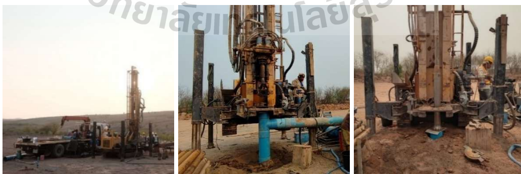
รูปที่ 3.10 ดำเนินการขุดเจาะในพื้นที่ศึกษา
