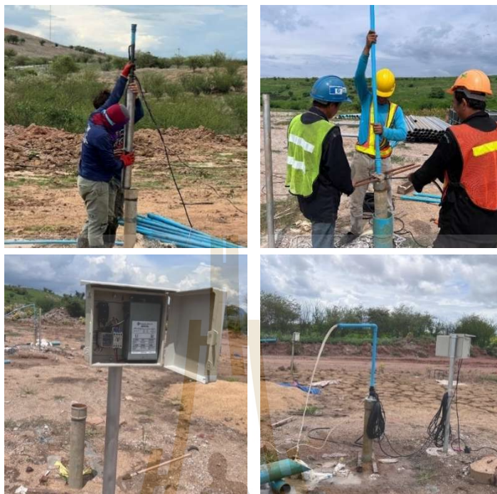
รูปที่ 3.14 ดำเนินการติดตั้งปั๊มสูบน้ำขนาด 1.5 แรงม้า (อัตราการสูบเท่ากับ 1000 ลิตร/ชั่วโมง)
