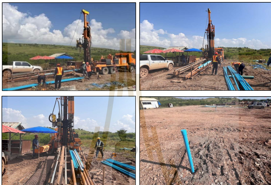
รูปที่ 3.16 การก่อสร้างระบบบ่อสังเกตการณ์เพิ่มเติมในพื้นที่ศึกษา
